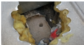
Dachaufbau aus versteckten Asbestzement-Wellplatten unter neuer Eindeckung aus Profilblech mit krebs-erzeugender Mineralfaserdämmung
