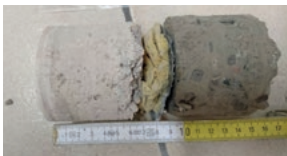
Bodenplatte aus Stahlbeton mit Trittschalldämmung aus krebserzeugenden Mineralfasermatten unter Estrich
