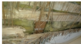
Dachinnendämmung aus krebs-erzeugenden Mineralfasermatten hinter verputzten Strohmatten
