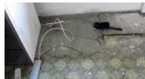
Bodenbelag mit asbesthaltiger Pappe an Unterseite
