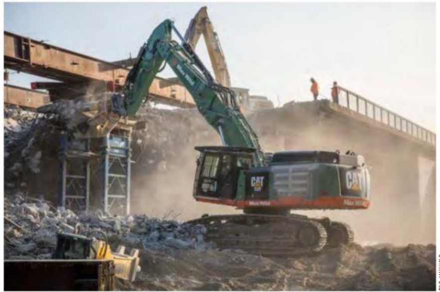
Insgesamt wurden durch die Firma Max Wild bereits sechs Brücken an der A99 abgerissen, drei sollen noch folgen.
