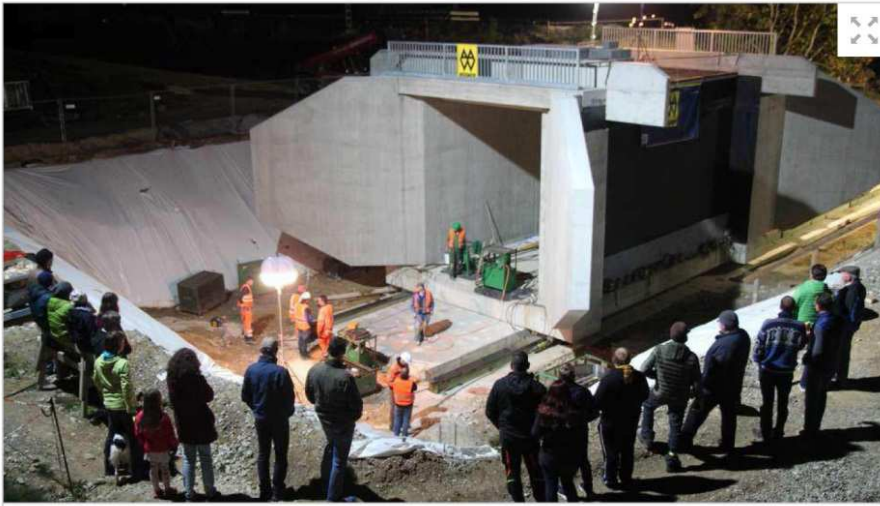
Die 740-Tonnen-Brücke bewegt sich. Die ersten zwei Meter sind unter den Augen von zahlreichen Zuschauern geschafft. © Kronenbitter
